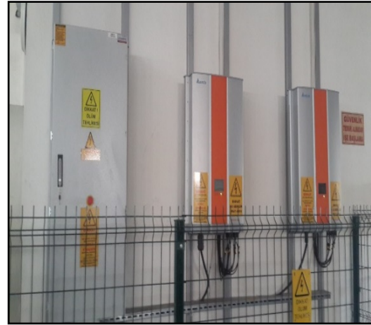
Şekil 3. Pano ve İnvörtörler
