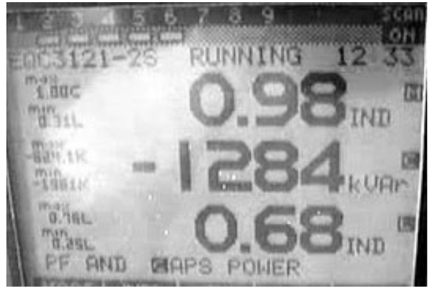
Şekil 8.Trafo istasyonu güç faktörü (Orta yük).
