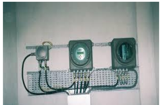
Onaylanması gereken tesisat
