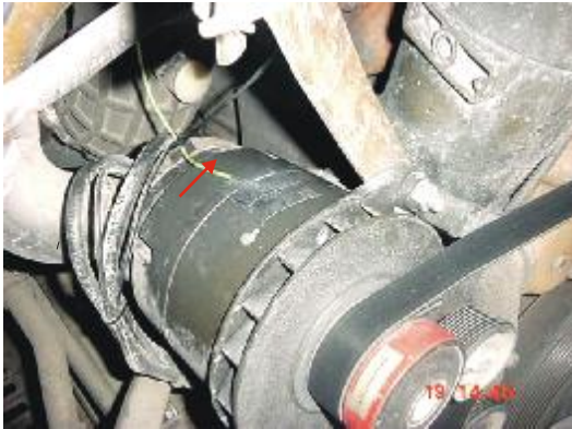
Şekil 4: Generatör üzerindeki termokupl
