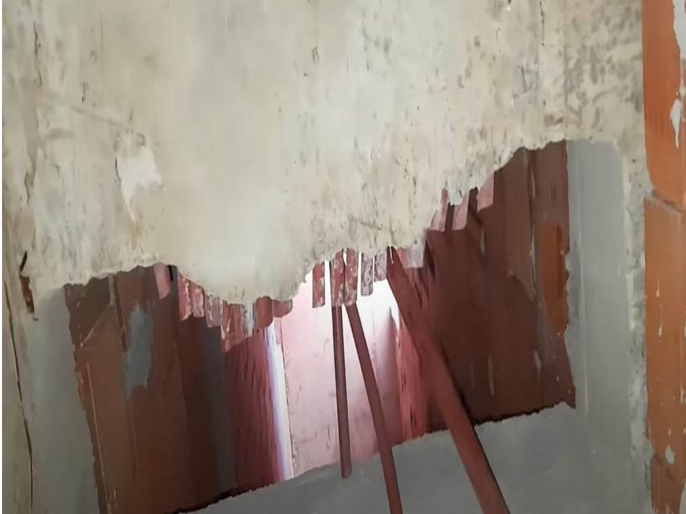
Kolon içi aşırı sayıda borulama tesisatı
