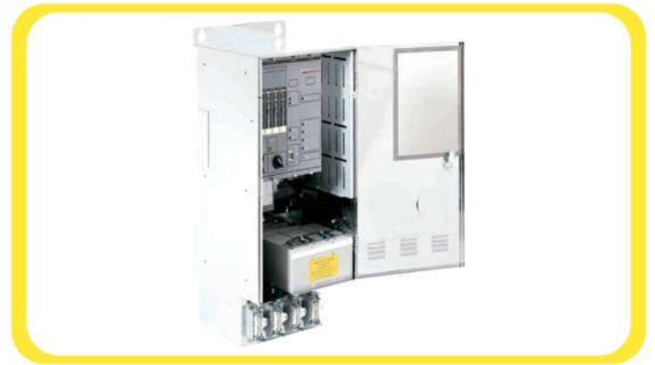
Şekil 3. Dört fider için entegre trafo merkezi kontrol ünitesi
