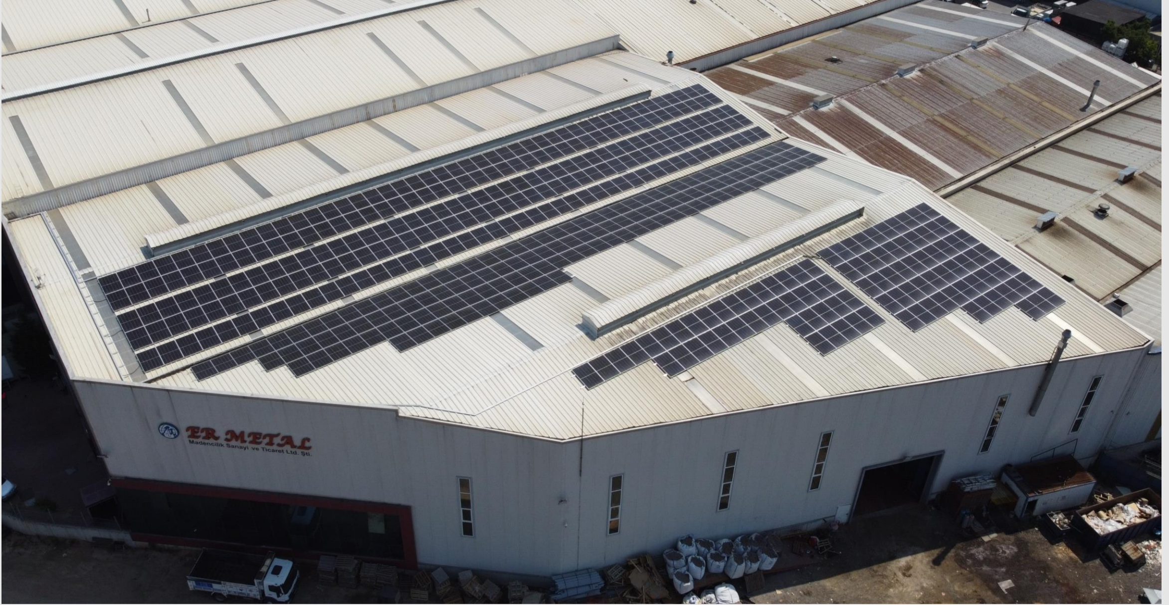
Er Metal Gebze/Kocaeli 249,06kWp/240kWe
