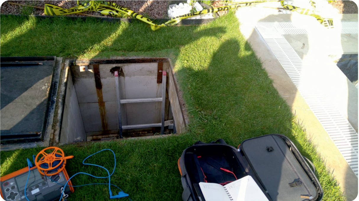
Kazanın yaşandığı havuz pompa dairesi
