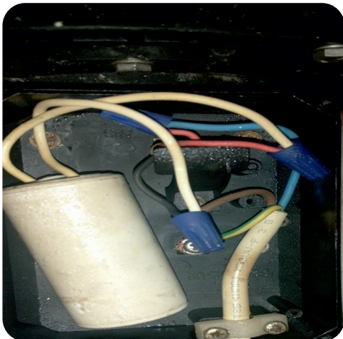
Hatanın başladığı havuz pompa motoru
