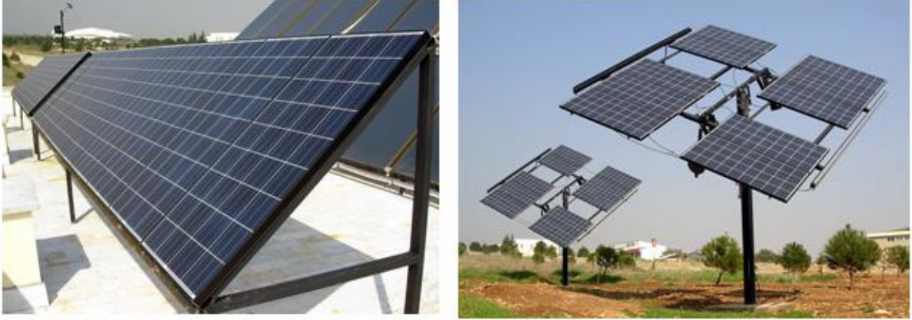
Şekil 1. 5kW gücünde fotovoltaik panel grubu
