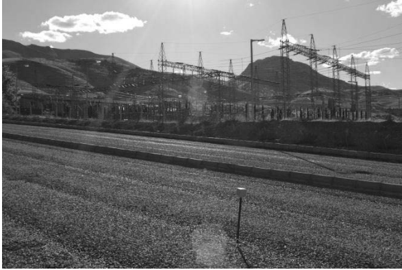
Şekil-7. Hastanenin güney batı cephesinde bulunan şalt sahasından 50Hz elektrik alan ölçümleri.
