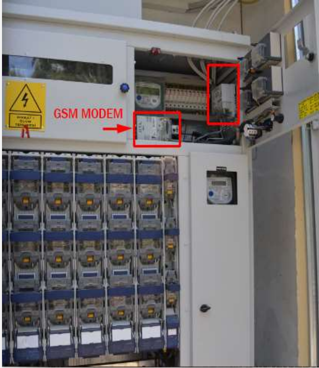
Resim 5 - 3. Trafo Bölgesindeki GSM modem ve trafo ana sayacı
