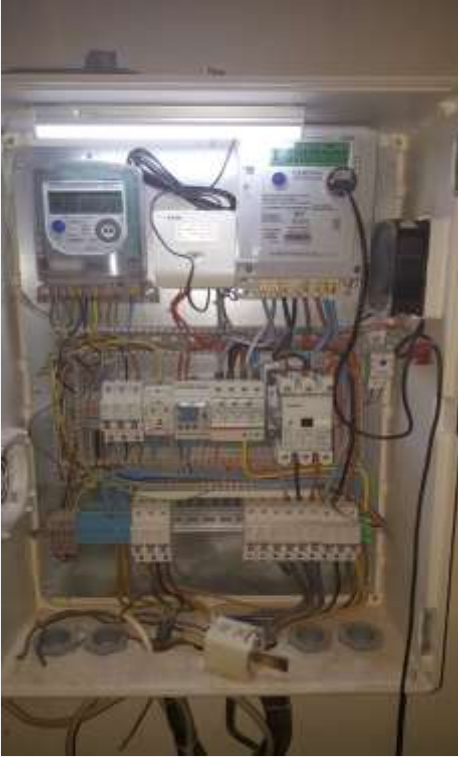
Resim 3 - 2. Trafo Bölgesindeki PLC'li trifaze trafo ana sayacı ve aydınlatma sayacı
