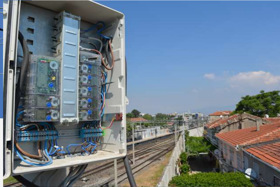
Resim 2 - 1. Trafo Bölgesindeki direk üzerine kurulumu yapılmış sayaç panosu
