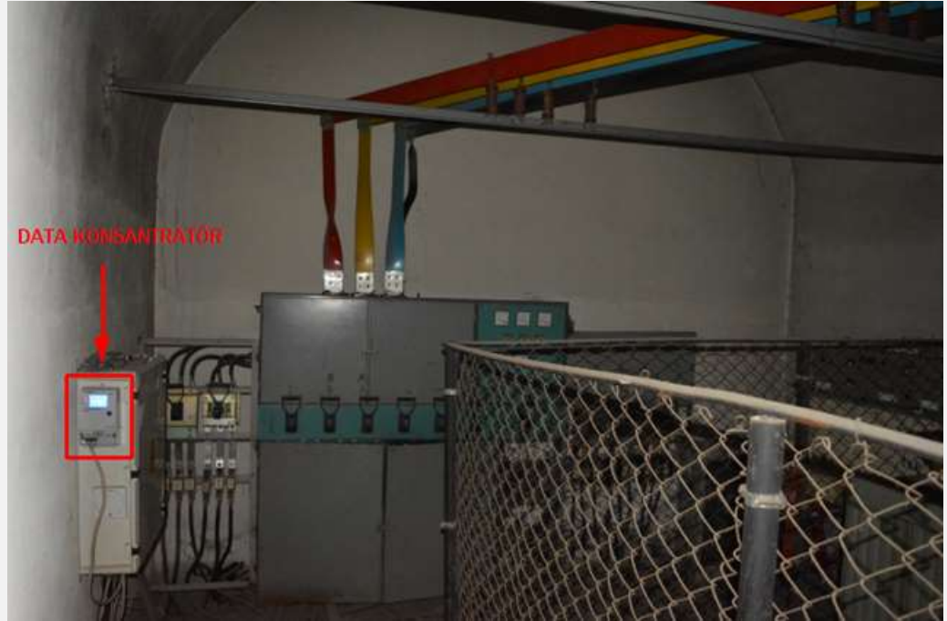
Resim 4 - 2. Trafo Bölgesindeki PLC'li trafo sayacı panosu ve Data Konsantratör
