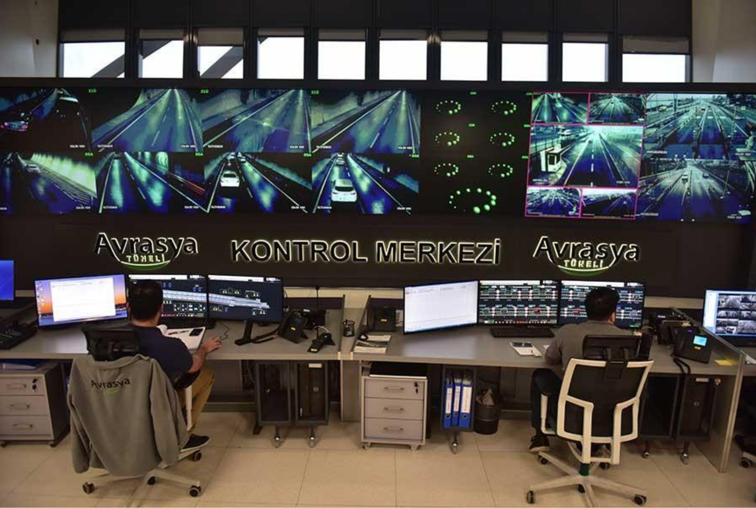
Avrasya Tüneli Scada Merkezi
