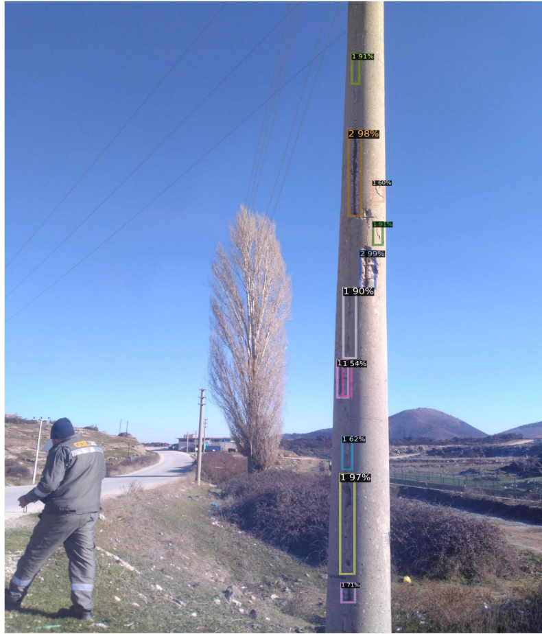
Şekil-3. Küçük çatlakları (1) ve aşınmış demirleri (2) olan bir beton direğin GDZ bakım görüntüsü
