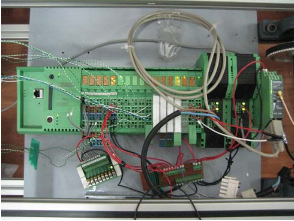
Şekil 2.2 PLC ve modüller
