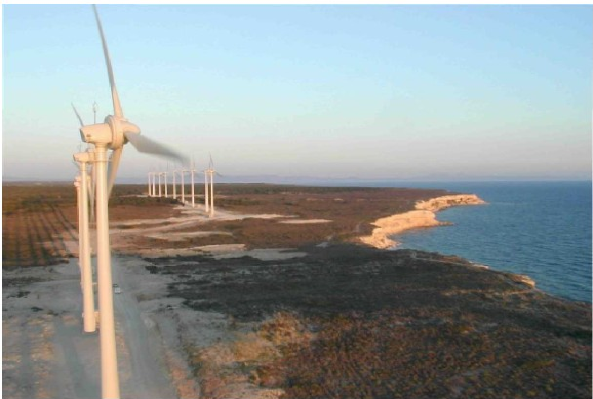
Şekil 2.12– Bozcaada rüzgar santrali, 17 \times 600 \text{ KW} = 10.2 \text{ MW} Haziran 2000
